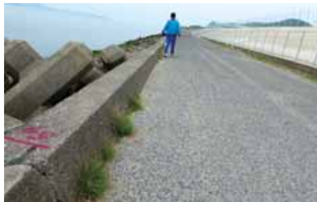
地震後の旧八幡残渣プール周辺の護岸と道路 (写真：水俣学研究センター)
