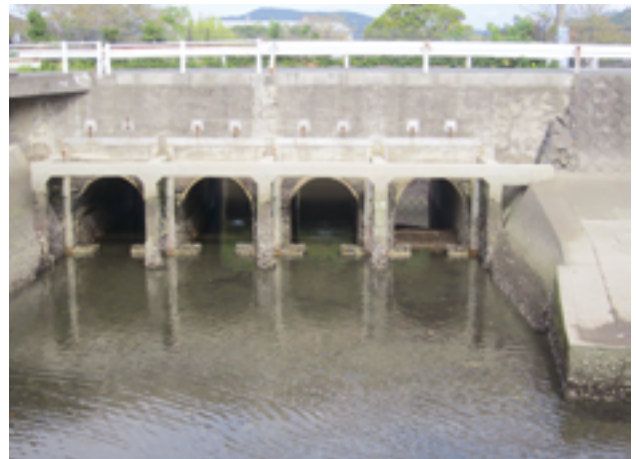
樋門が取り外された百間排水口(写真:2023年10月1日 筆者撮影)
