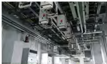
装置間は天井のOHTで運ぶ
