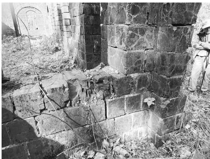
図 13 持倉鉱山遺構における鑄造鋳滓煉瓦劣化事例
